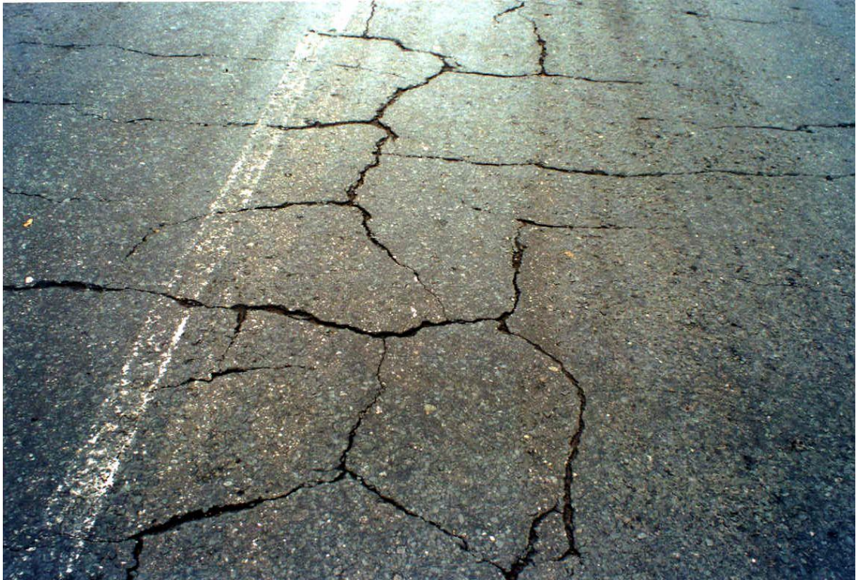
Рисунок 3 – «Блочная» Сетка Трещин
