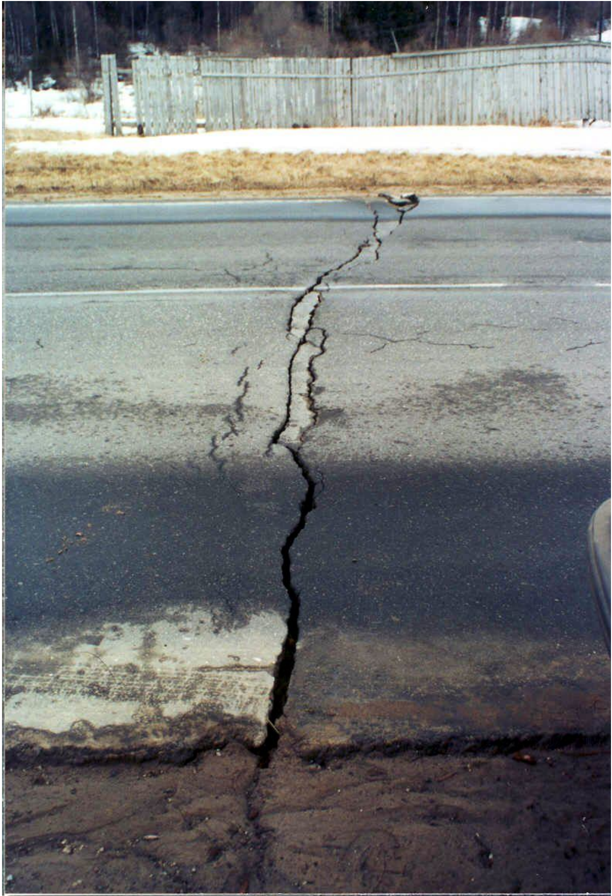
Рисунок 1 – Поперечная Температурная Трещина
