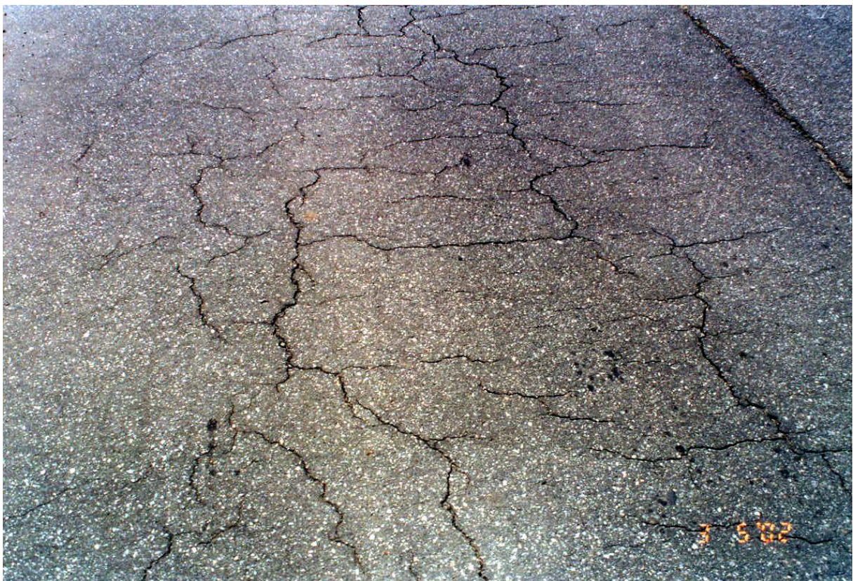
Рисунок 4 – «Крокодиловая» Сетка Трещин
