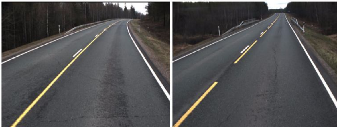
Рисунок 10. Участок 505, направление 1: Фото слева: 350 м. Поперечные трещины, вызванные дифференциальным морозным пучением, на участке косогора. Фото справа: 3200 м. Вызванная воздействием мороза продольная трещина перед мостом.
