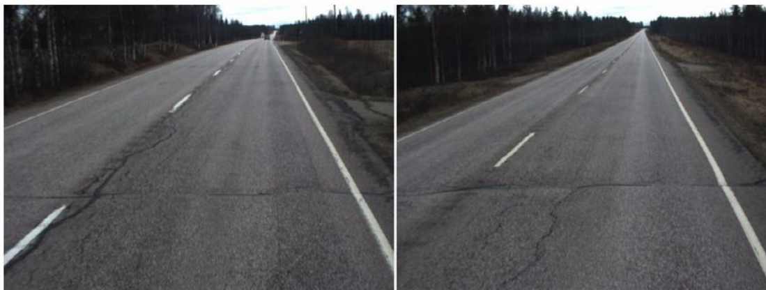
Рисунок 12. Участок 515, направление 1: фото слева: 4000 м. Продольные, поперечные трещины и сетка крокодиловых трещин. Фото справа: 4460 м. Продольные, поперечные трещины и сетка крокодиловых трещин.
