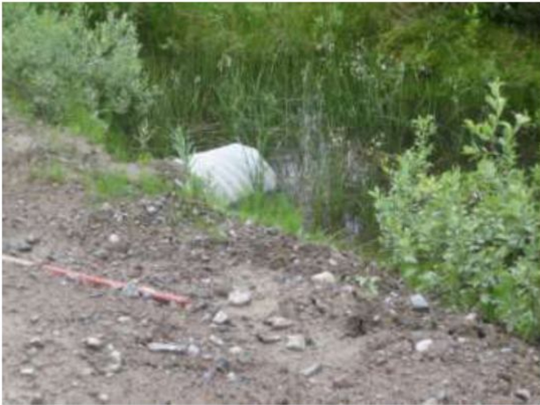
Рисунок 4 Вода в канаве подходит близко к поверхности трассы
