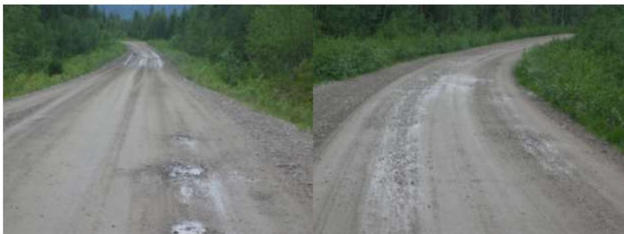
Рисунок 2 Состояние дороги в июле 2010 г.
