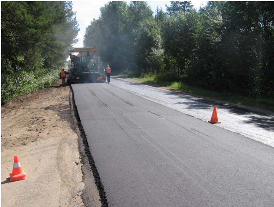
Рис.2. Укладка асфальтобетонной смеси приготовленной на основе БИТРЭК на а/д. Котлас - Коряжма - Виледь – И. Подомское км 55+800 – 56+400
